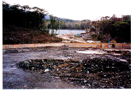
6. 神着貯水池に流入した泥流と土石流対策の砂防堰堤
