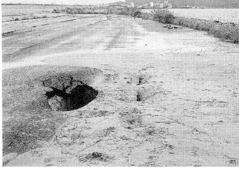
写真-1 堤防に観察された陥没（揖屋）
