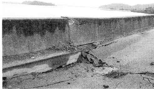
写真-2 堤防の段差（安来）
