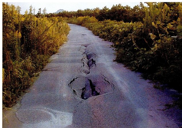
5. 陥没した道路（彦名）
