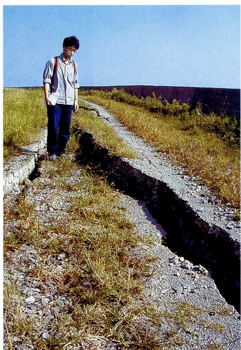
1. 堤防の内側に観察された亀裂（弓浜）
