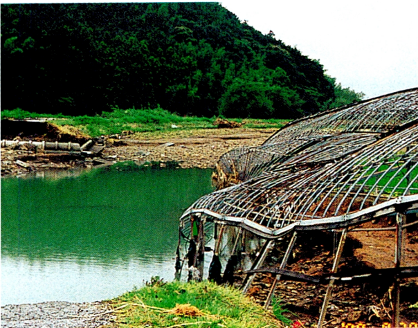
8. 河川堤防の崩壊により倒壊したニラハウス（高知県南国市久礼田、高知県農林水産部提供）
