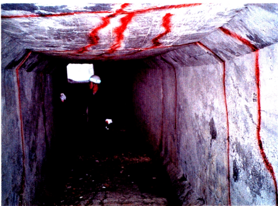
12 奥池の底樋ボックスカルバートのクラック (三木土地改良事務所 提供)
