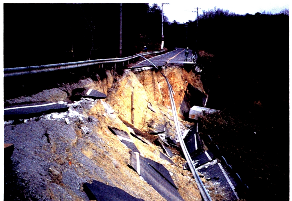
13 奥池の道路(堤体上部)の崩壊
