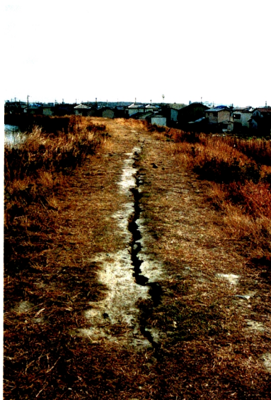
5 八十島池の天端の縦断クラック
