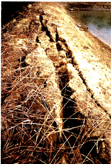
4 口無池の上流法面の縦断クラック
