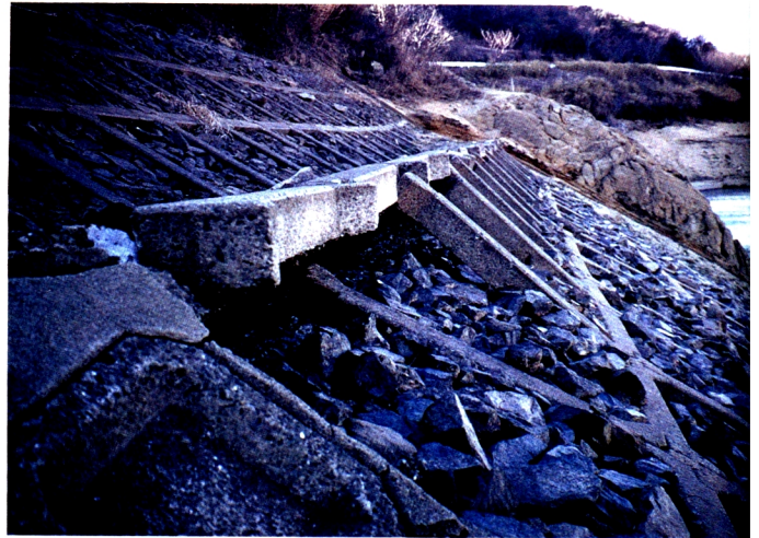
15 常盤ダムの左岸上流池敷法面 の枠組み工の損傷
