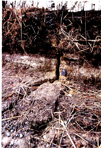
2 砂池の左岸部の横断クラック(上流側)
