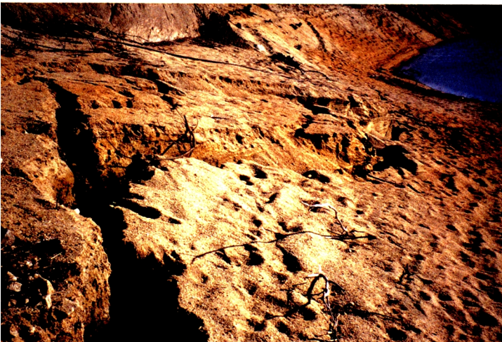
16 大谷ダムの左岸上流池敷法面のクラック
