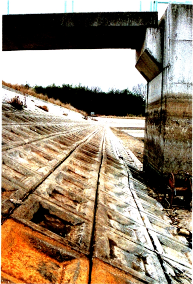
1 鳴池の上流法面のはらみ出し
