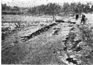
寫眞第 6. 南秋田五里合村 龜裂及缺潰
