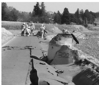
写真-1 マンホールの突出と路面沈下の状況
