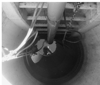
写真-2 マンホール内の滞水状況（通水障害による仮ポンプ圧送）
