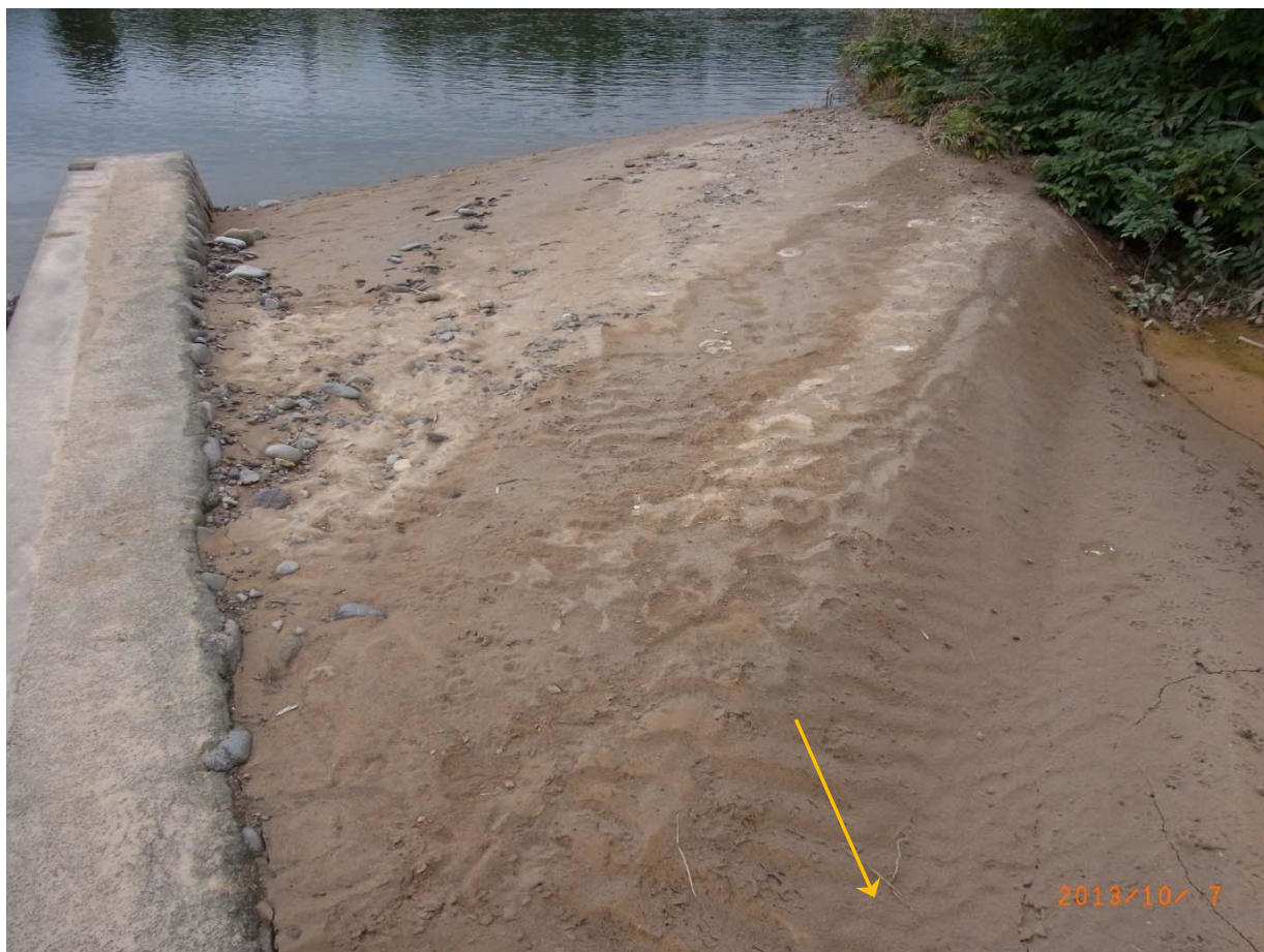
図－11 矢筈堰（岩手県葛根田川）低水路取水口付近の堆砂による導水阻害（2013年10月7日撮影）
