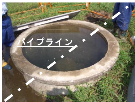
写真-1 空気弁位置での漏水
