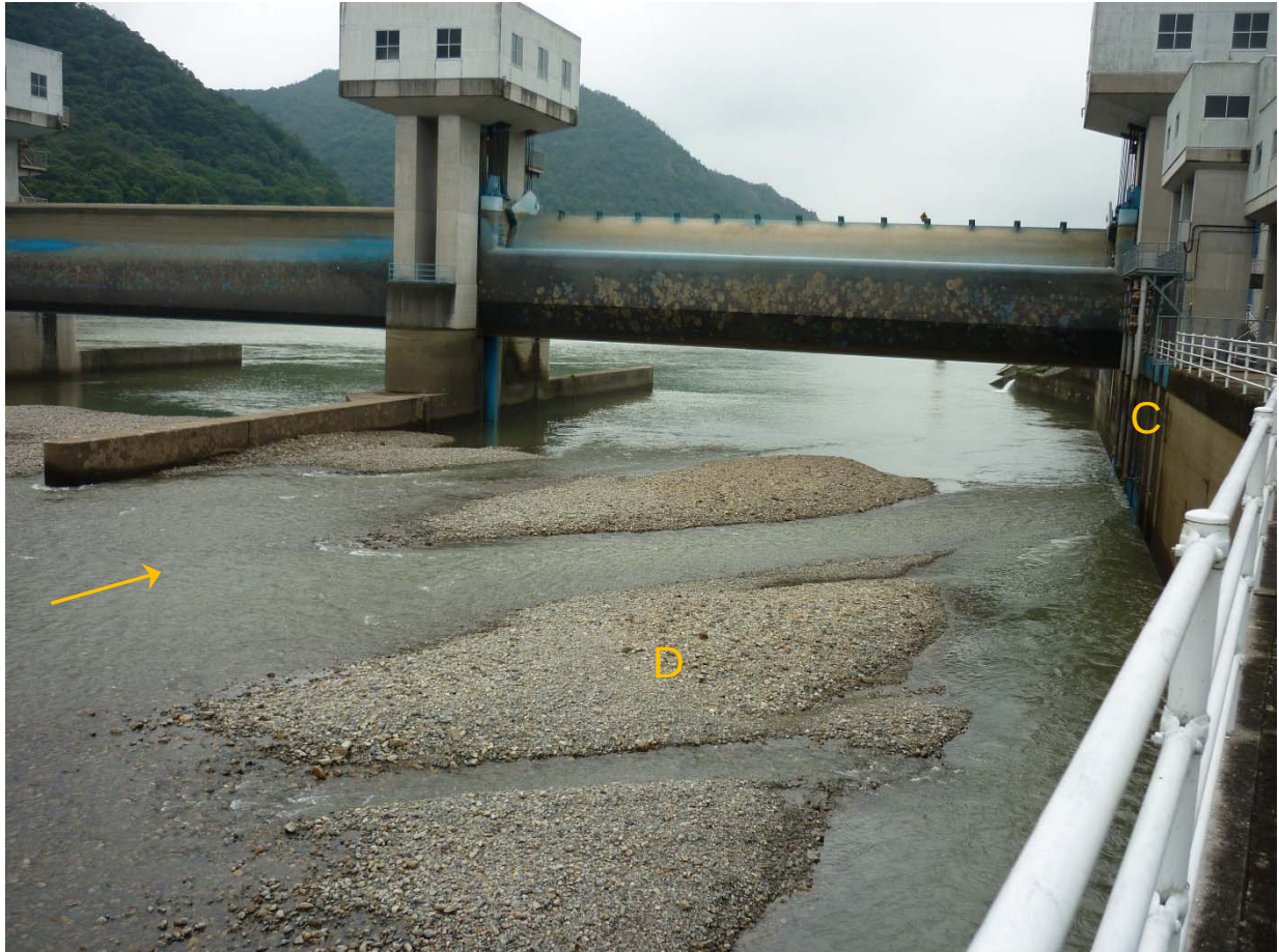
図－5 新田原井堰（岡山県吉井川，和気町）取水口前の堆砂
