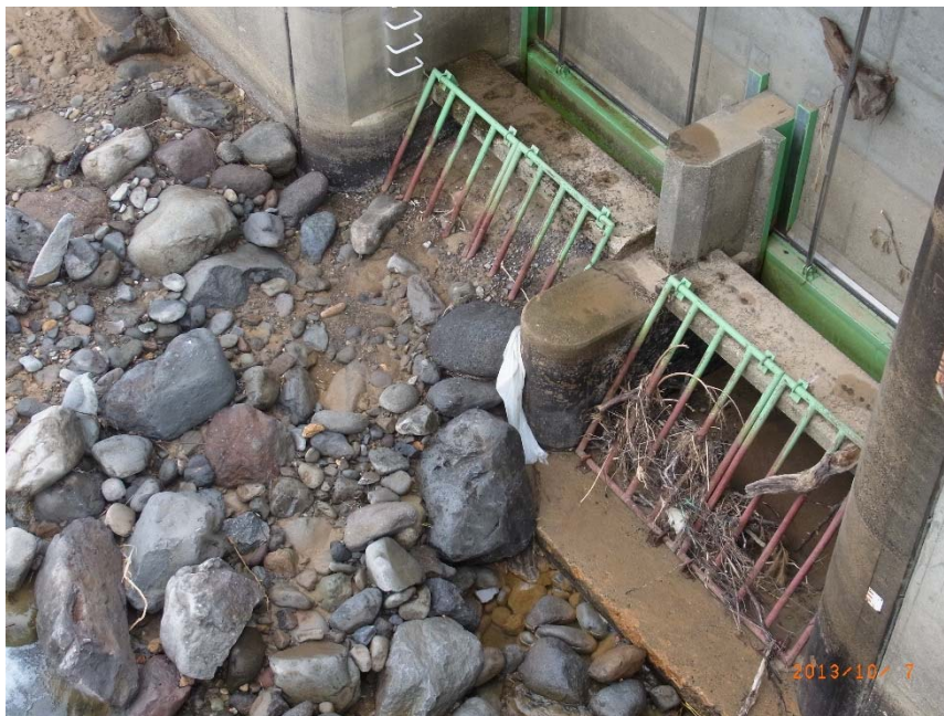
図-1 篠ヶ川原頭首工の取水口閉塞状況（2013年10月7日撮影）
