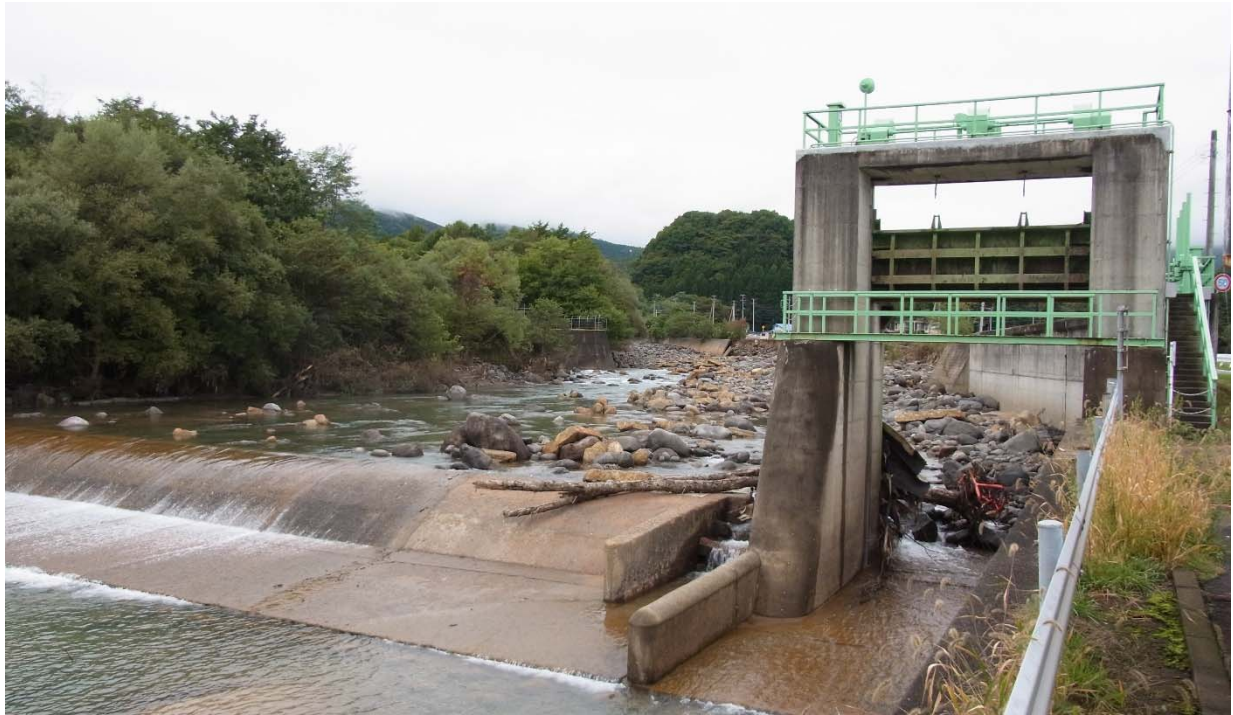
図－2 篠ヶ川原頭首工付近の砂礫堆形成状況（2013年10月7日撮影）
