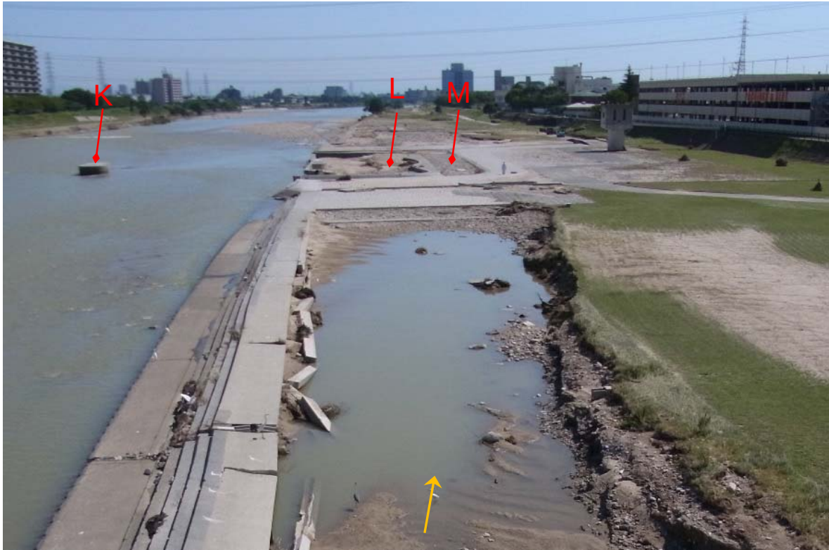
図-12 百間樋井堰（兵庫県武庫川，西宮市）上流の高水敷表面の洗掘と取水路および魚道への堆砂
