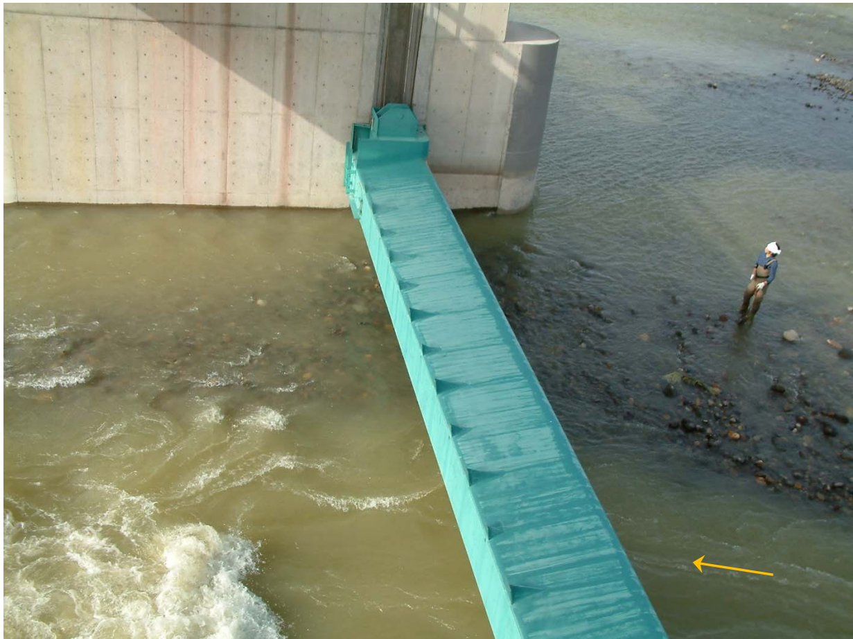
図-10 忠別川第3頭首工（北海道東神楽町）2号ゲートが閉鎖できなかった様子（2013年4月28日撮影）
