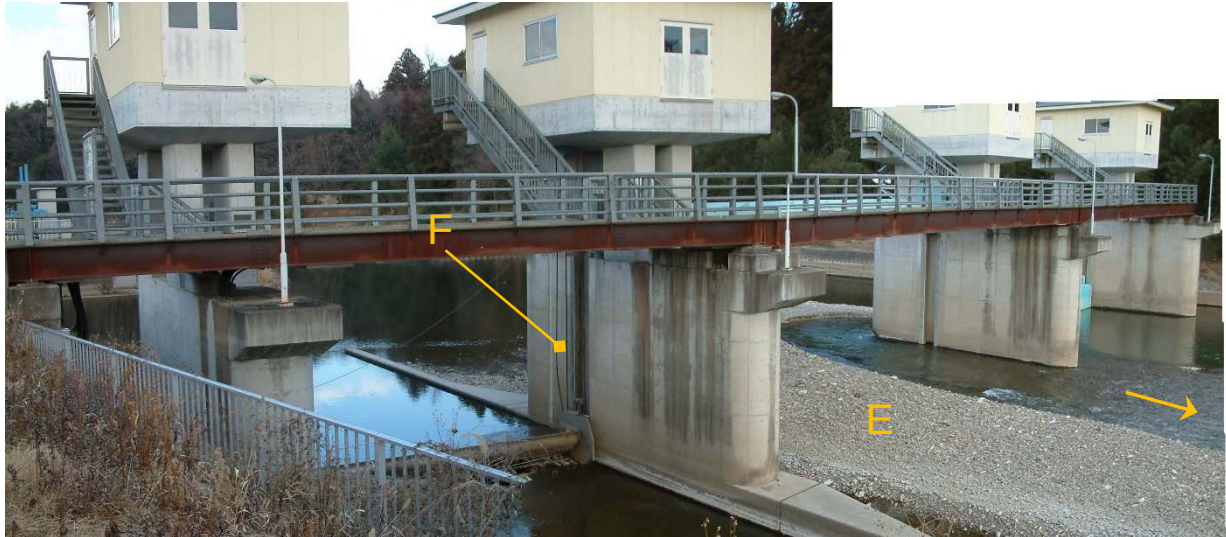
図－7 森田頭首工（那珂川支流荒川，栃木県那須烏山市）における可動堰ゲート閉鎖障害
