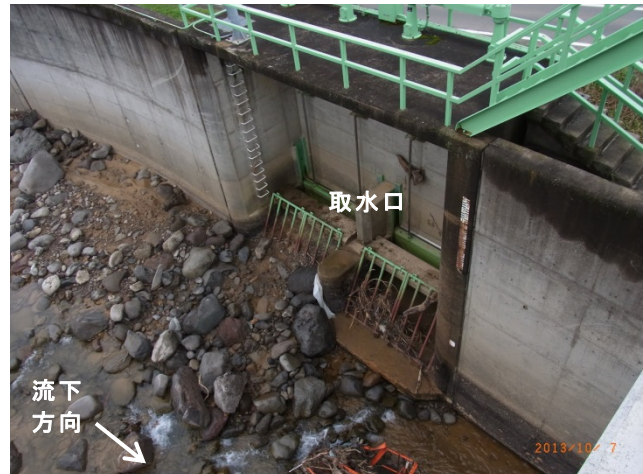
Fig. 4 篠ヶ川原頭首工取水口の堆砂による閉塞状況(2013年10月7日撮影)
