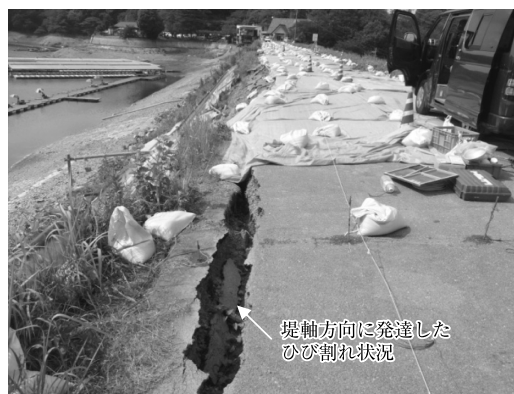
写真-1 堤頂部において堤軸方向に発達したひび割れ
