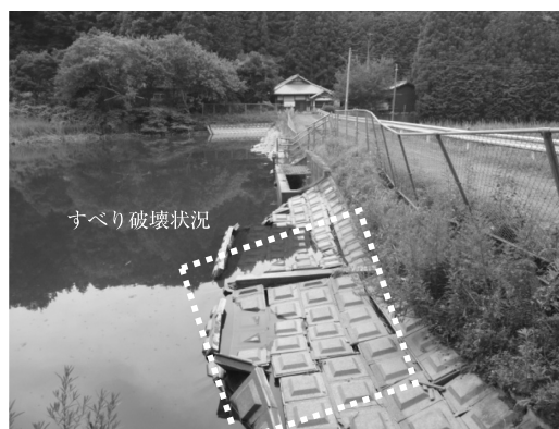
写真-2 法面の沈下およびすべり破壊
