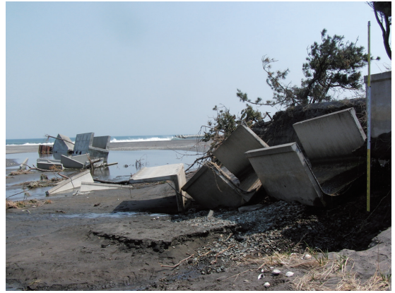
写真-3 (b) 淋代中央排水路の海岸出口部の損壊・流出
