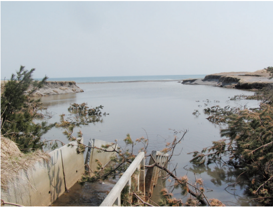
写真-3 (a) 六川目北排水路の海岸出口部の損壊・流出
