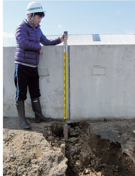
写真-1 (b) 東俣 1 号幹線用水路の継目目地の破損 (置き樋構造による二次製品施工)
