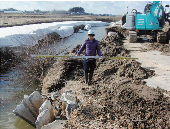
写真-1 (c) 土淵堰用水路右岸の法崩落
