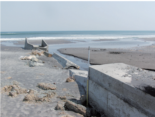
写真-3 (c) 淋代南排水路の海岸出口部の損壊・流出
