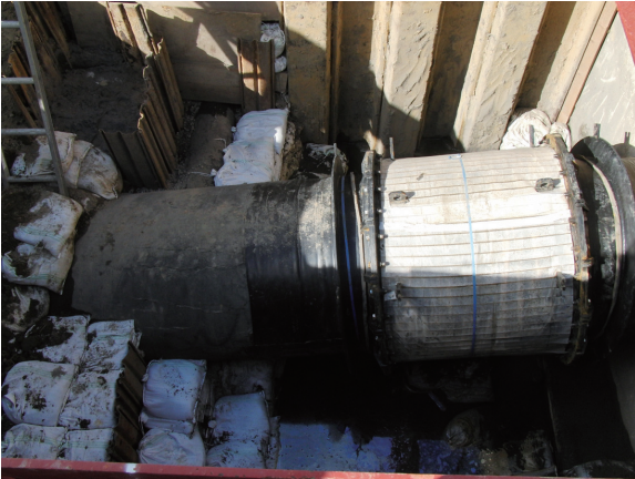
写真-1 (a) 芦野幹線用水路第 5 号分木工 (可とう管の破損)
