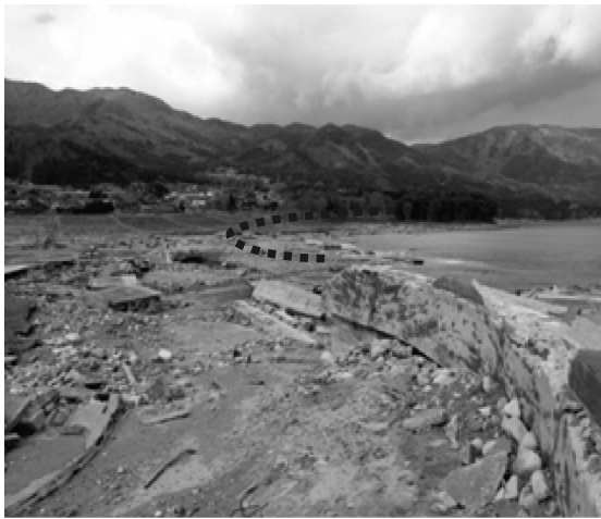
写真-5 大船渡市吉浜海岸 被災状況
