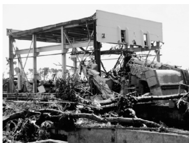
写真-1 被災した排水機場
