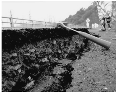
写真-3 大柿ダム堤体天端の亀裂状況
