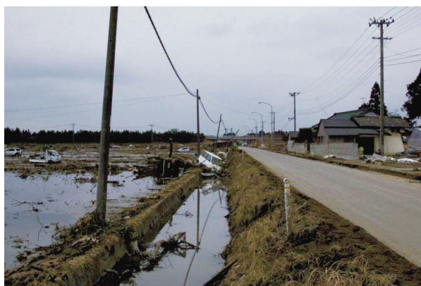
水路（仙台市若林区笠神）車が水路に落ちている。水田、水路とも水は残ったまま。
