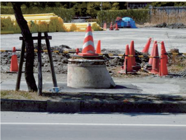
液状化で 70 cm ほど浮き上がったマンホール （日の出、この区間で最大のもの）
