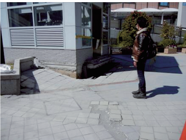
京葉線新浦安駅前のエレベータ前が 40 cm ほど地盤が下がっていた。
