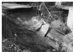
道路陥没(管の露出)
