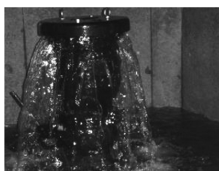
空気弁からの漏水
