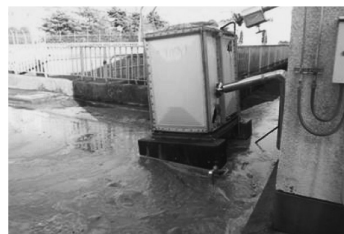
写真-8 被災した東庄揚水機場
