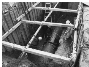
写真-6 管路からの漏水状況（成田用水）
