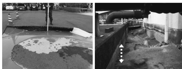
液状化による噴砂
