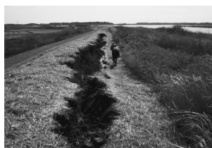
写真-5 印旛沼堤防の被災状況
