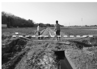
写真-2 管理設部の地表面沈下状況
