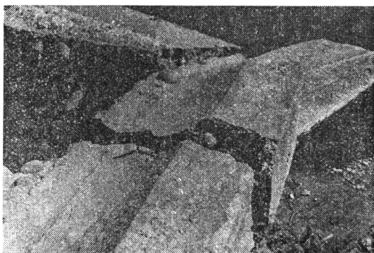
写真 6 玖珠堰被害状況 (左岸袖の欠潰状況)
