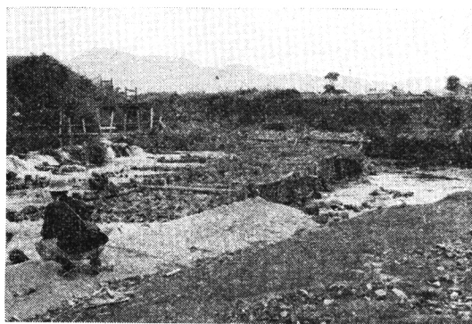
写真 8 保木下堰被害状況
