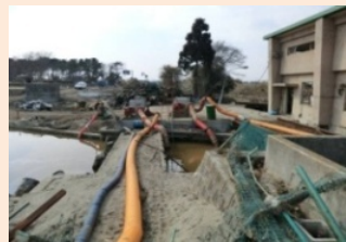
＜応急ポンプ設置＞
